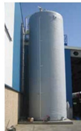
RÉSERVE INCENDIE VERTICALE AÉRIENNE 120.000 L
