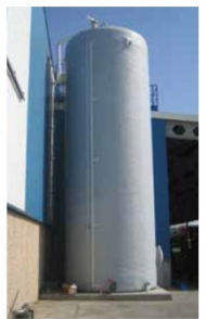
RÉSERVE INCENDIE VERTICALE AÉRIENNE 120.000 L
