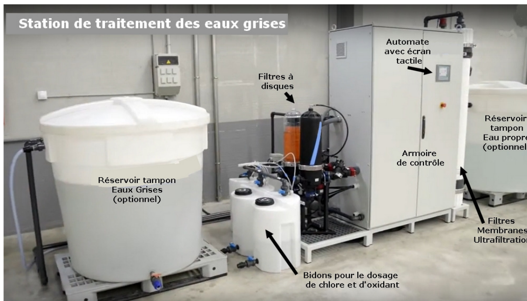
Traitement des eaux grises en provenance des douches, baignoires, et lavabos.
